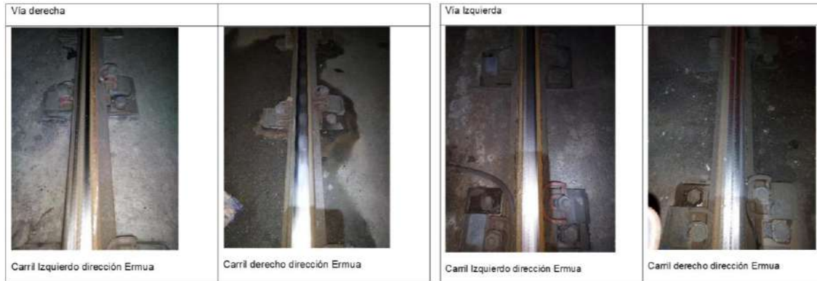
Figura 20. Defectos en la zona de andenes – Placa. Las dos primeras Vía 2 y las segundas Vía 1.
