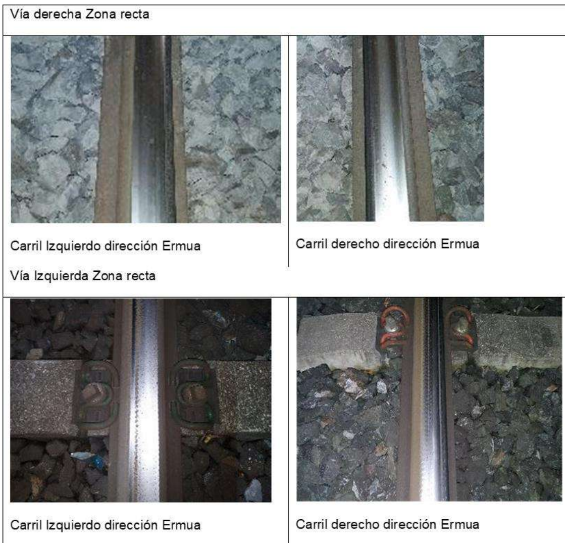
Figura 27. Defectos en la vía Tramo 3 – Zona recta.
