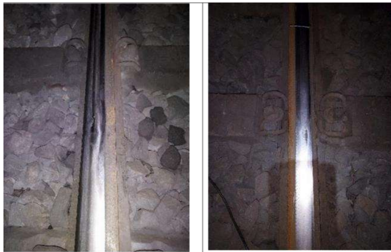
Figura 16. Defectos en la vía en el límite del Tramo 1 – Balasto entrada estación.
