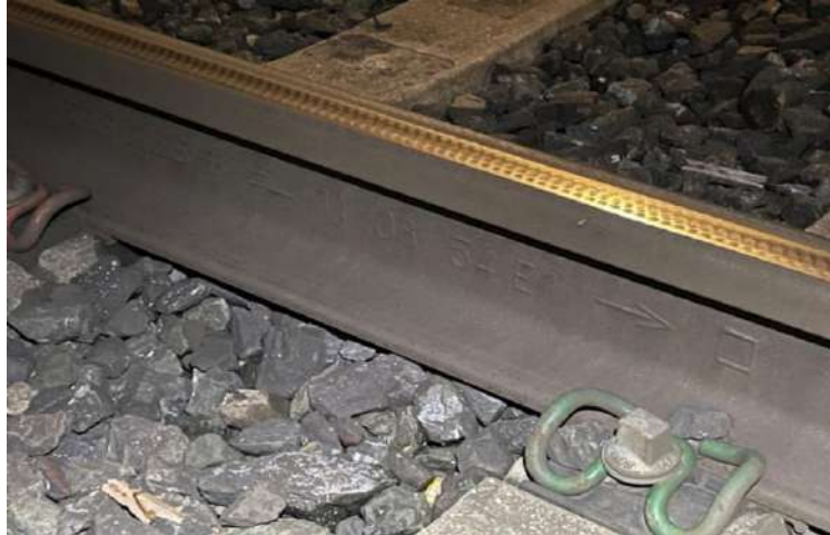
Figura 30 Defectos en la vía Tramo 4 – Hospital.
